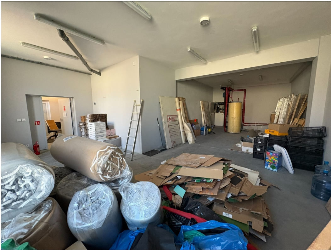
Fot 3. Brak symptomów nieprawidłowej pracy istotnych elementów konstrukcyjnych (belki, słupy)
