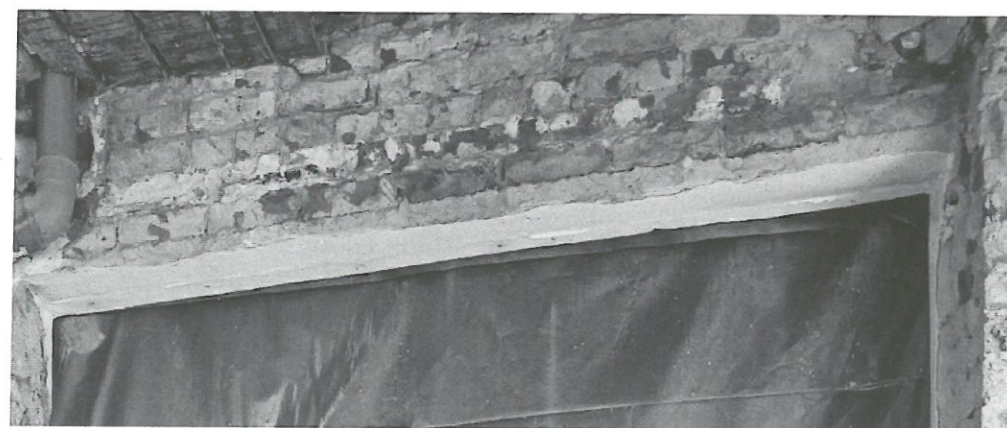
Fot. 4 Brak elementu (nadproża) nad otworem w wewnętrznej ścianie usztywniającej.
