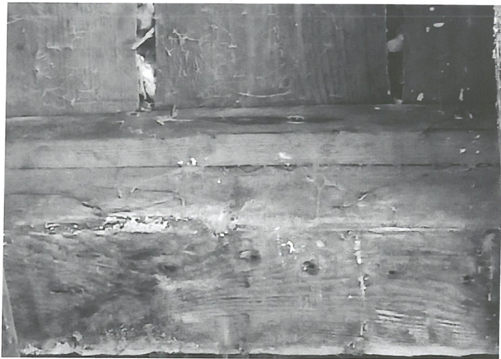
Fot. 6 Odkrywka stropu – widocznełaty 5x3cm pod ślepym pułapem oraz belka stropowa
